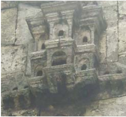
Ayazma Camii, (Bahçenin sağ giriş kapısının sağ duvarından, yanında şirin bir kuş “balkonu” da bulunur.
